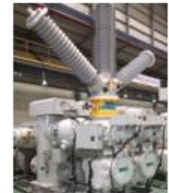
145kV 가스절연 개폐기
